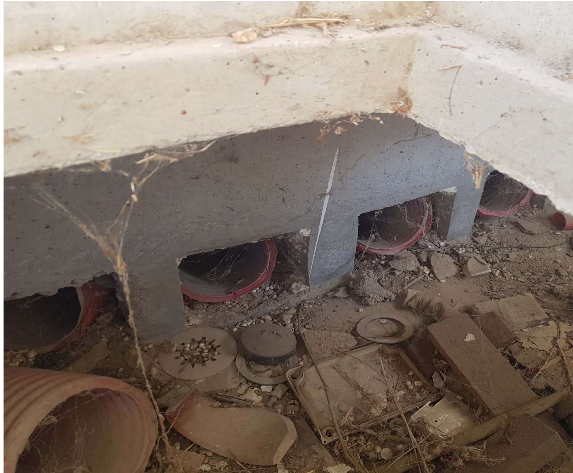
Fotografía nº9A(Detalle salida 2 edificio CT3)
