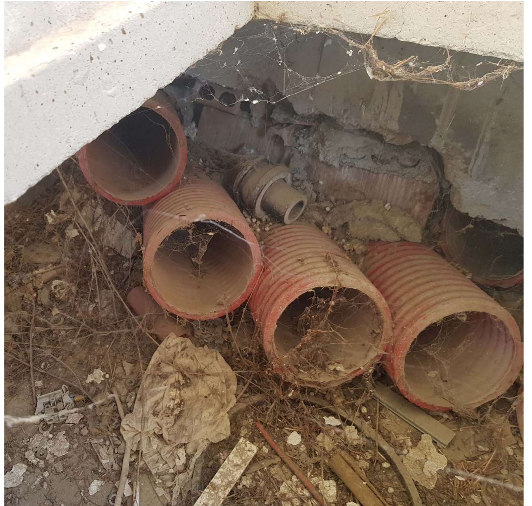
Fotografía n°9(Detalle salida 1 edificio CT3)
