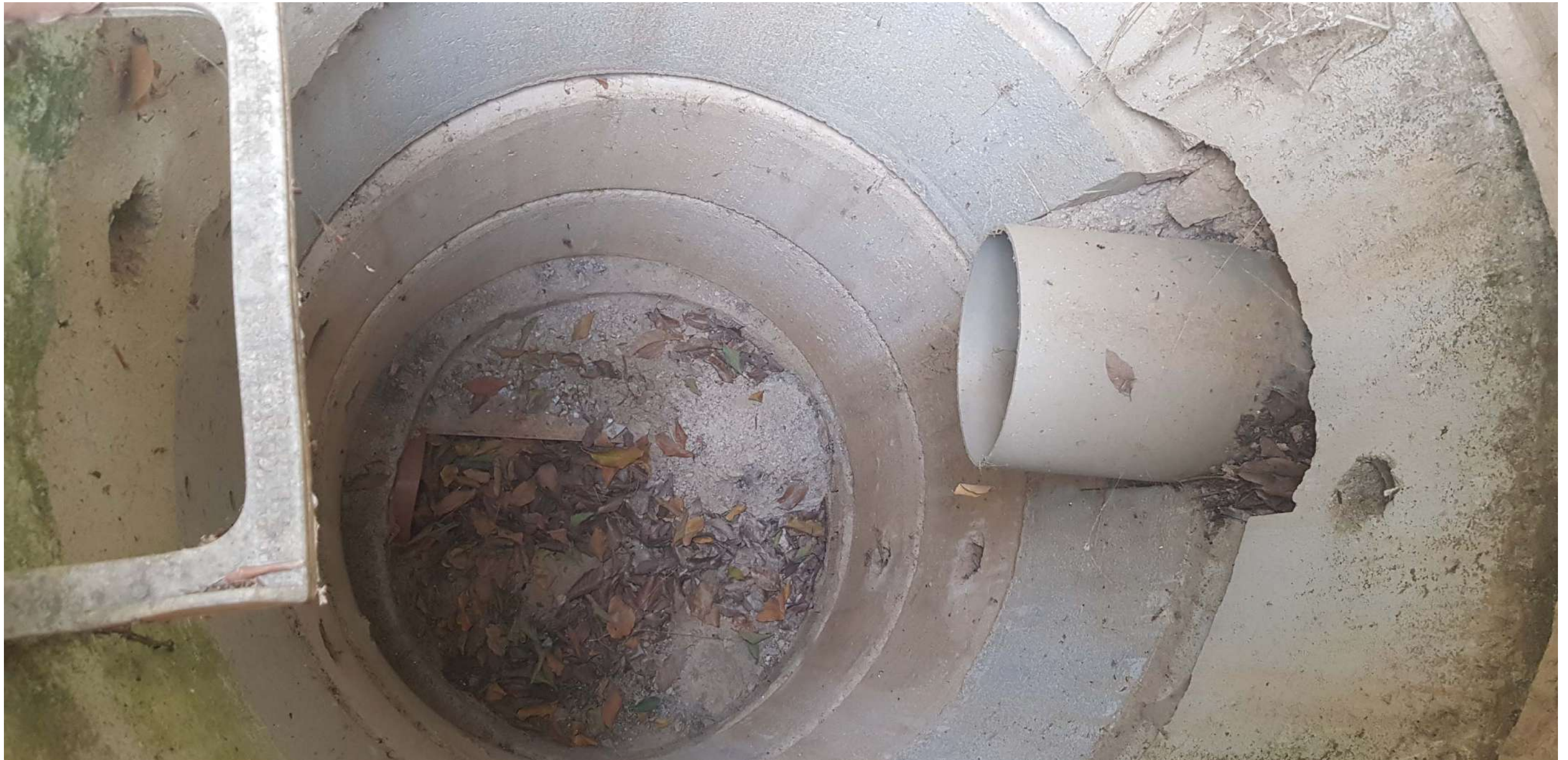
Fotografía nº16 A (pozo saneamiento límite parcela A3)
