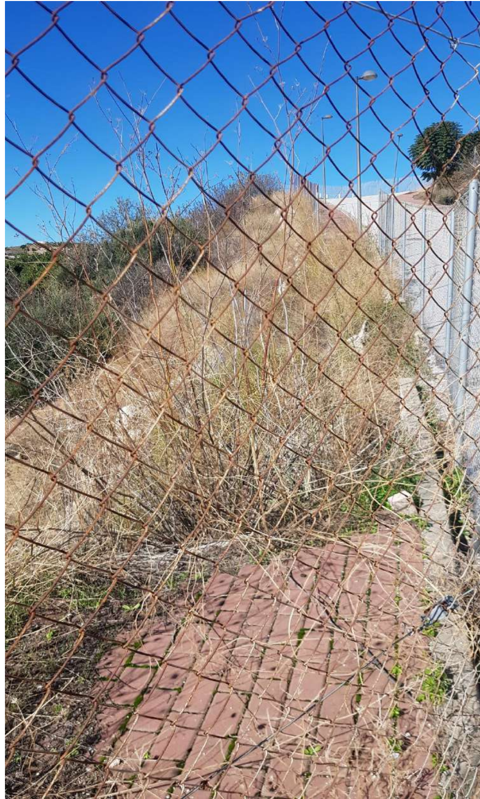
Fotografía nº18 A (detalle zona hundida)
