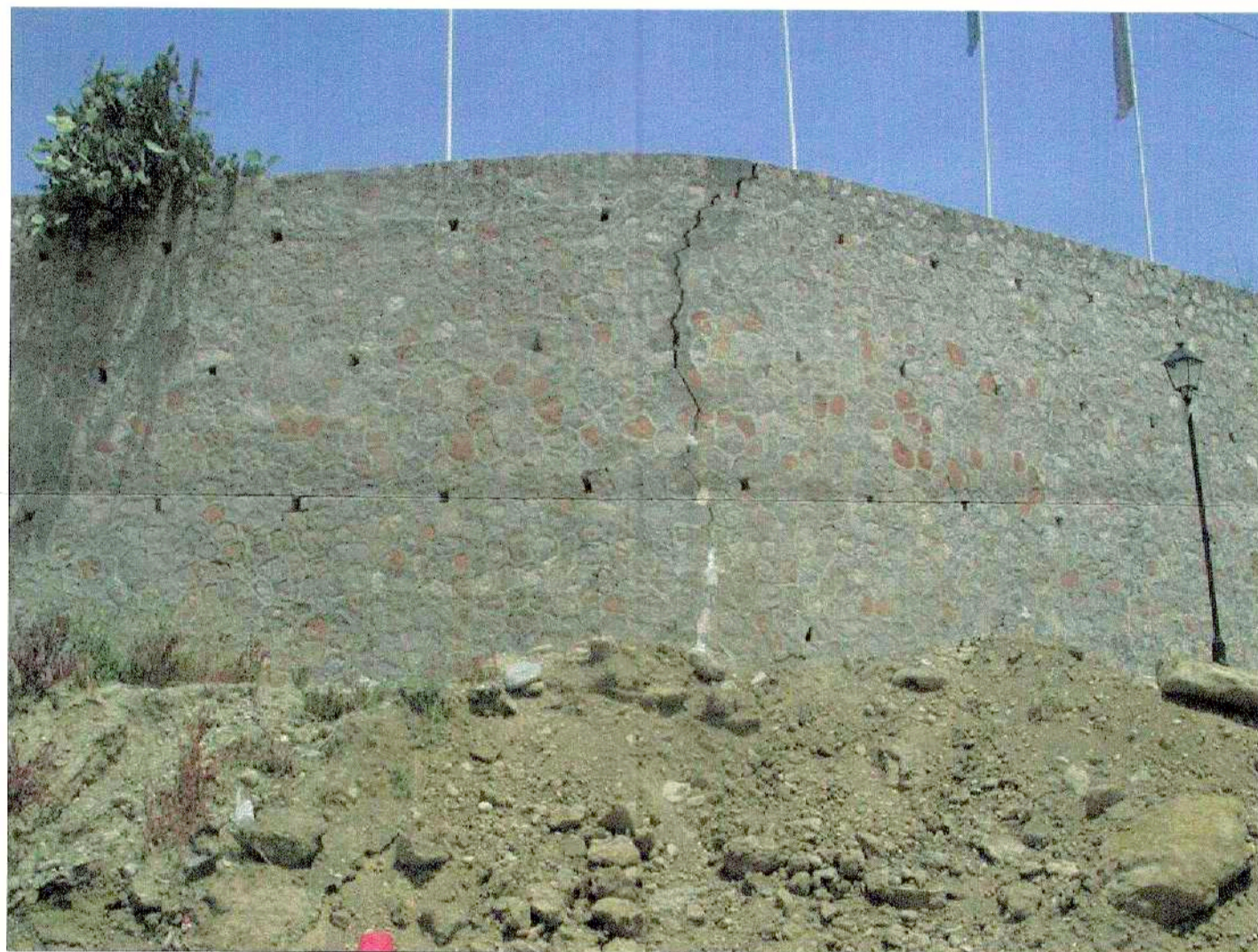
Fotografía nº 6. - Podemos ver la curva del muro, por el centro de la cual discurre una gran grieta que amenaza con partir el muro.
