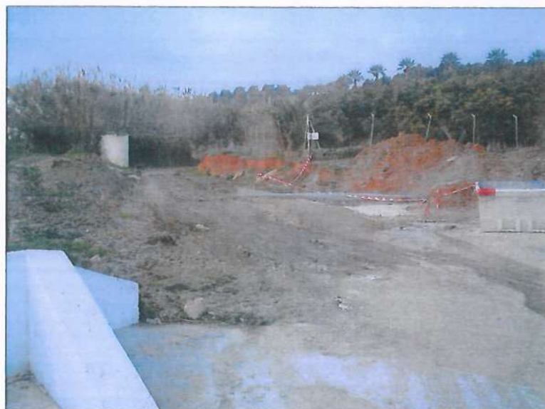
Ilustración 11: Vista del arroyo del Pozo Moyano, sobre el que han practicado un camino de tierras. Las cintas rojas y blancas marcan el inicio de una obra de paso de ese barranco bajo el vial en el que nos encontramos, que lo cruza perpendicularmente.
